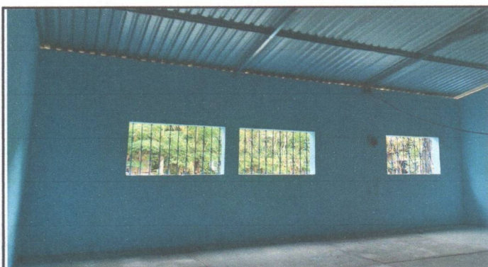
Foto 3: Aula con buena ventilación.
